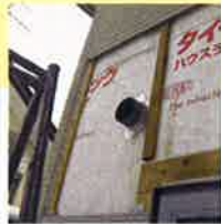
フードの 取付け不良
