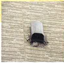
換気口の周りの 建材のいたみ
