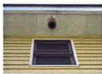
軒裏の 換気不良
